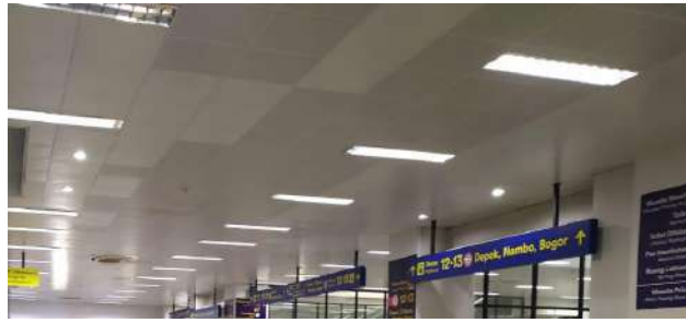
Gambar 2. Lampu Pada Transfer Hall Stasiun Manggarai
